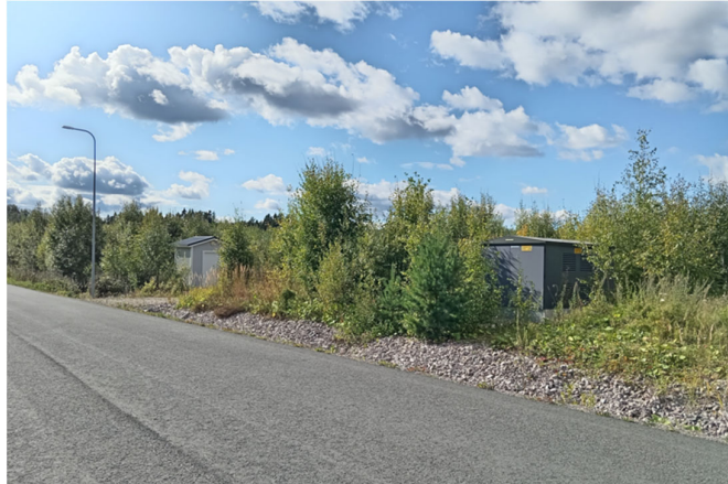
Kuva 27. Suunnittelualueen jätevesipumppaamo ja sähkömuuntamo Rastimaa-kadun varrella (Janakkalan kunta, 2025).
