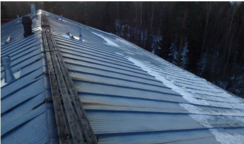
Kuva 80. Vesikate on tyydyttävässä kunnossa. Kattosillat ovat heikossa kunnossa.
