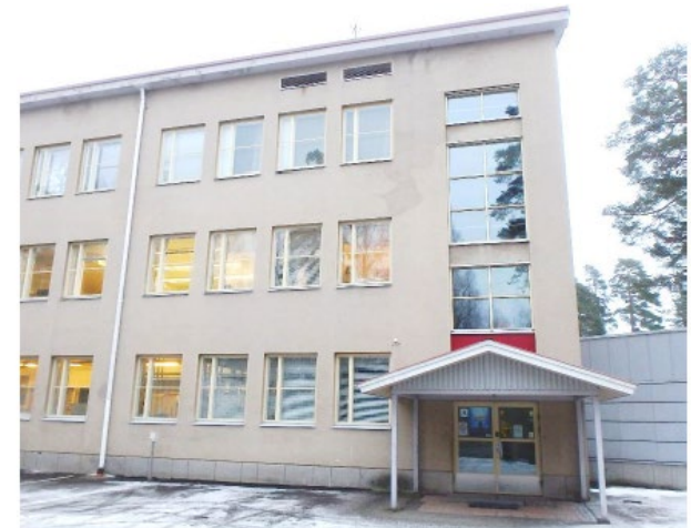
Kuva 71. Rappausta on paikkaparattu. Katoksen sadevedet kastelevat sokkelin.
