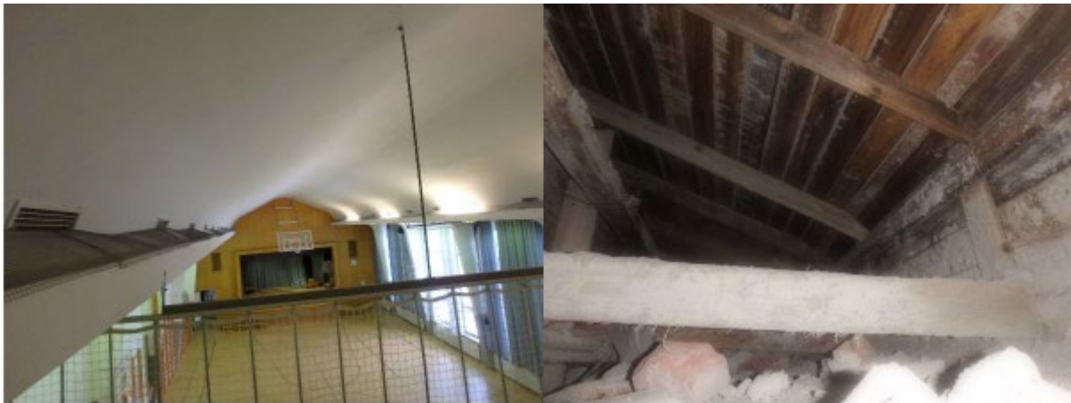
Juhlasalin kattorakenne ja yläpohjan paikoin vaurioitunut harvalaudoitus.
