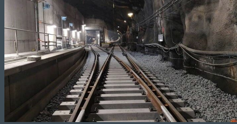
Metro, raiderakenteet, sähkö- ja turvalaitejärjestelmät
