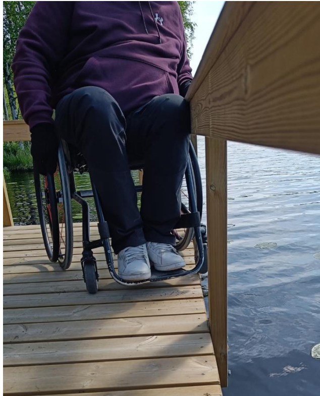
Kuva 12 Ilman suojakynnyksiä pyörätuolin pyörät voi pyörähtää pois laiturilta
