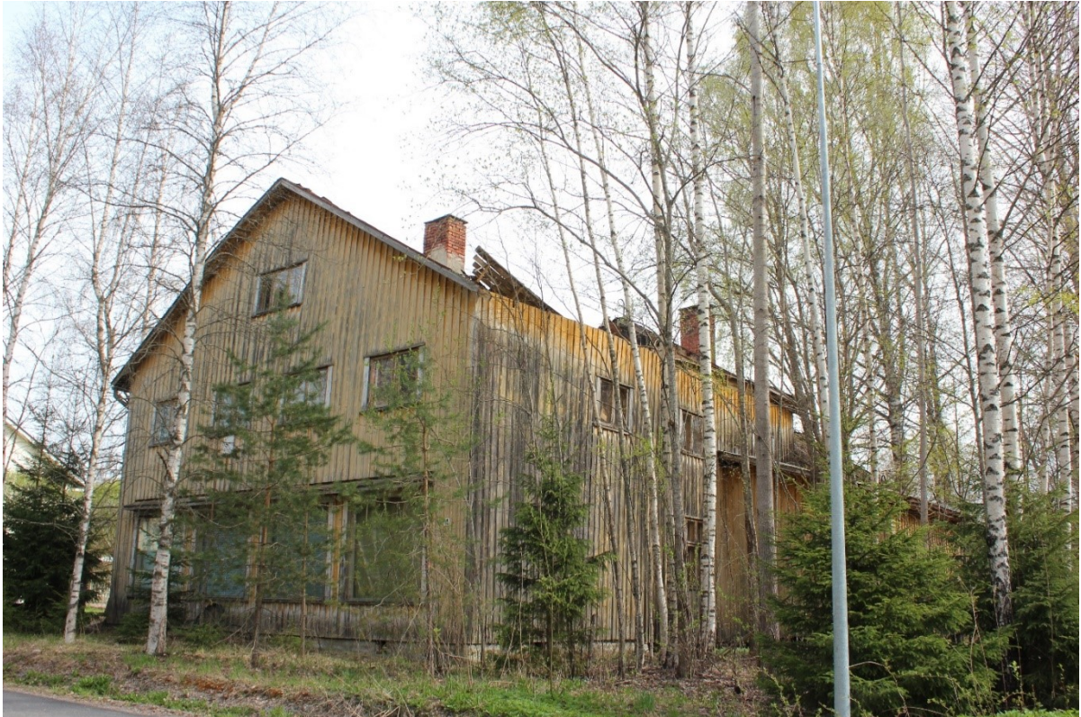
Rakennus 17. Vuonna 1950 valmistunut kookas rakennus on purkukuntoinen. Rakennus on vanha liikerakennus. Oikean puoleisella tontilla on sijainnut VPK:n talo.
